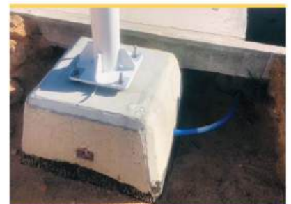
قواعد كمرات المراقبة
